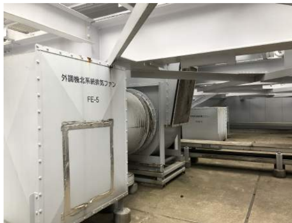
・ 外調機排気ファン
