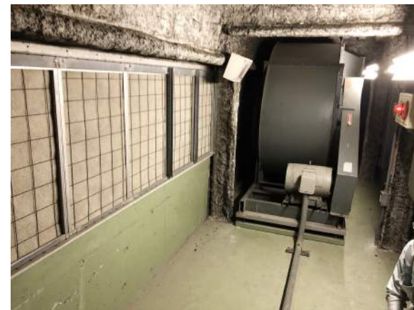
・ 外調機給気ファン (給気フィルター)
